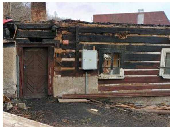
Vyhořelý roubený dům č.p. 208, jehož dveře se staly součástí sbírky MMŽB
